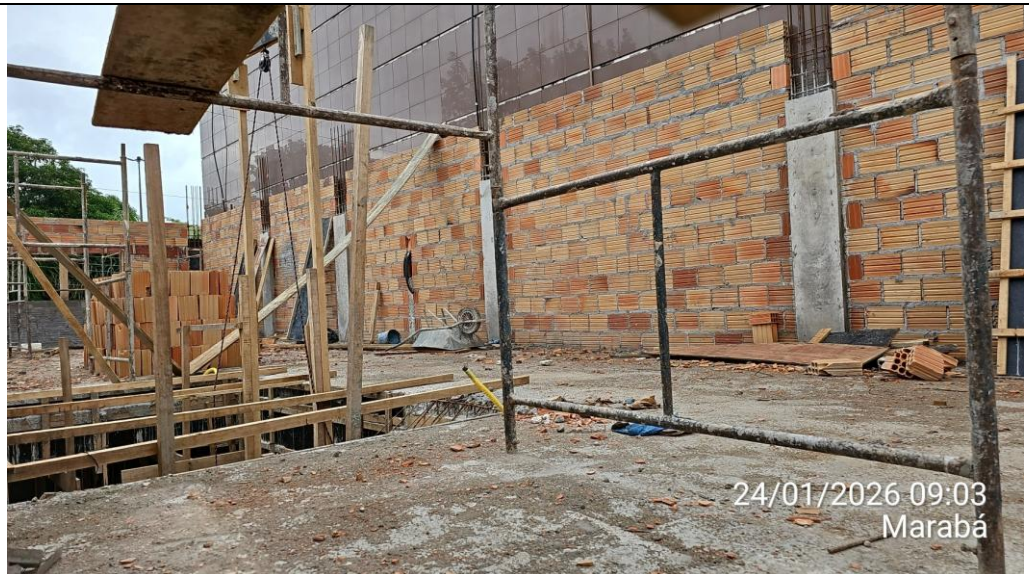
Anexo 02 – Instalação de água fria da guarita do estacionamento:
