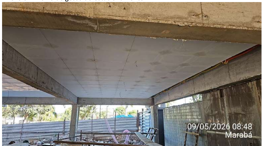
Anexo 02 – forro de gesso do estacionamento:
