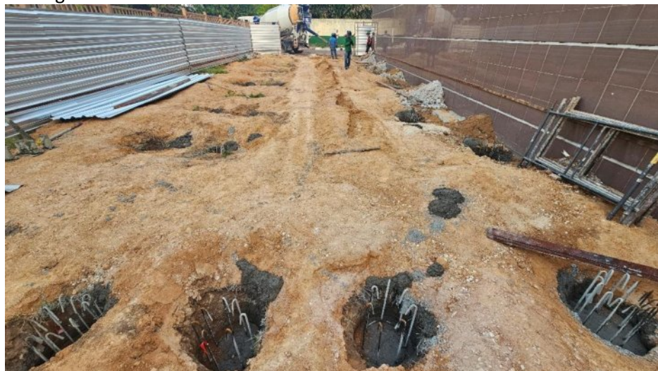
Corpos de prova do concreto utilizado nas estacas do Anexo 01:
